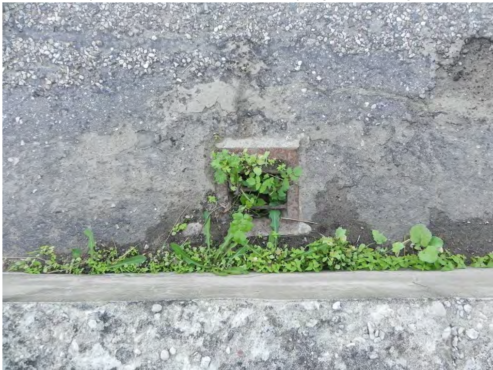
7 pav. Vandens nuvedimo šulinėliai ant tilto užnešti ir apaugę žole
