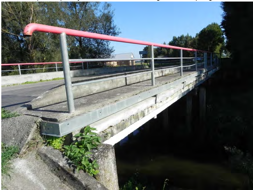
5 pav. Metaliniai tilto turėklai pažeisti korozijos
