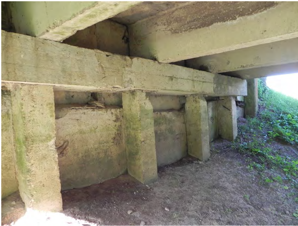
12 pav. Pažeistas krantinių ir tarpinių atramų apsauginis betono sluoksnis, koroduoja laikančioji armatūra
