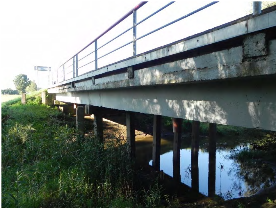
9 pav. Sijų apsauginis betono sluoksnis pažeistas, koroduoja laikančioji armatūra
