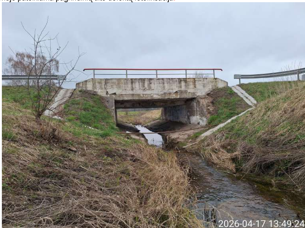
3 pav. Tilto fasadas, surūdiję turėklai ir pažeidimai betono konstrukcijose
