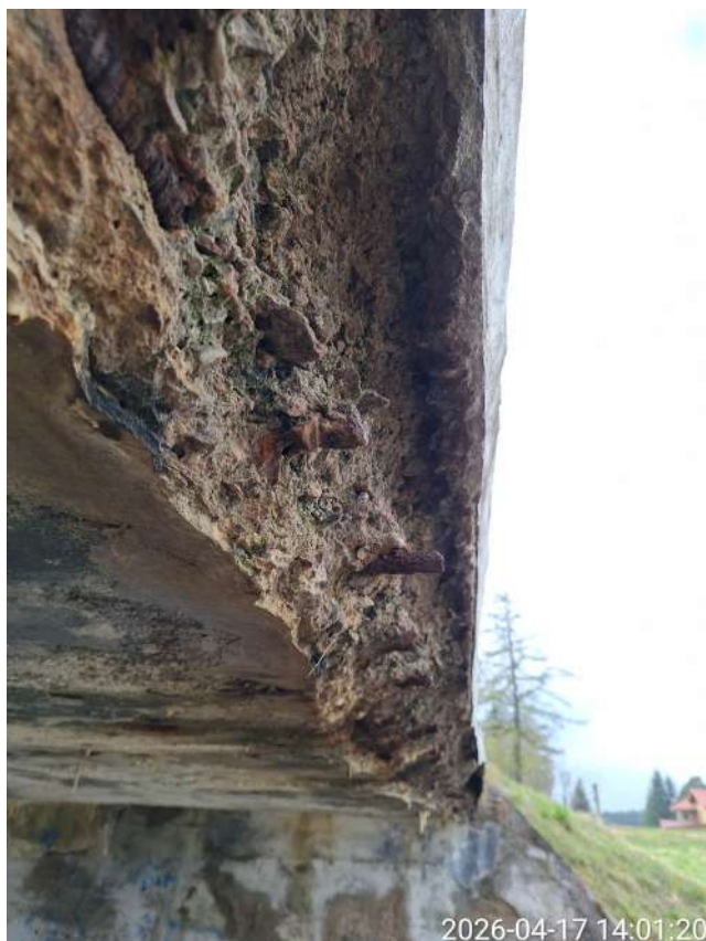
pav. 5 Pažeidimai perdangos plokštėse
