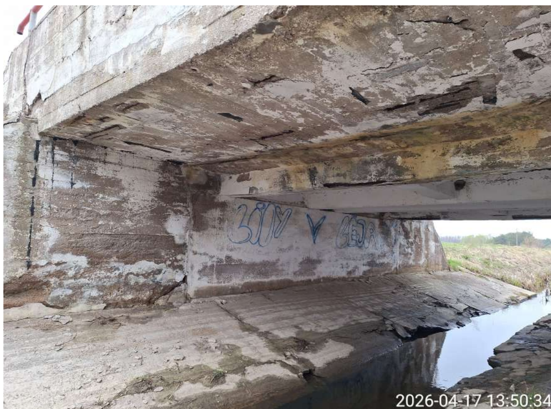
8 pav. Defektai krantinėse atramose
