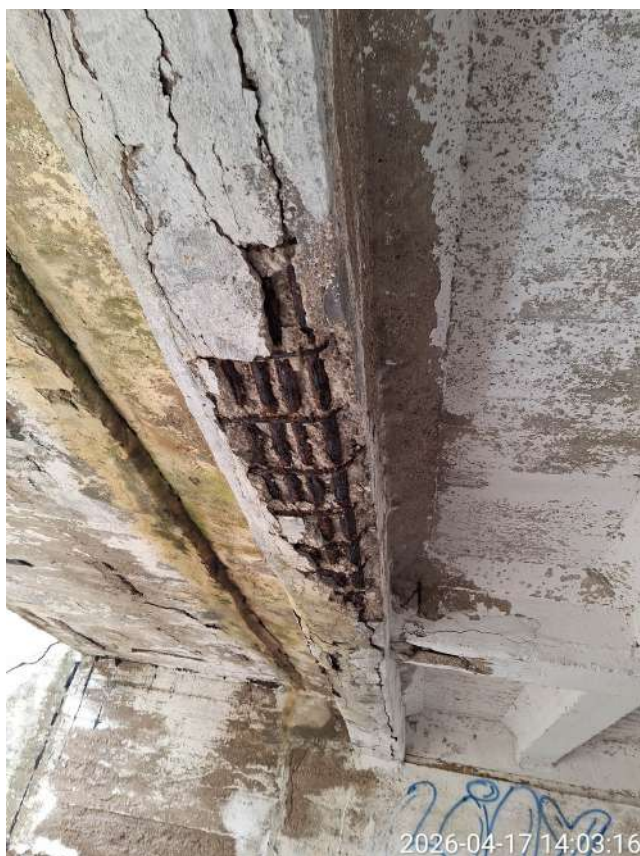
6 pav. Pažeidimai perdangos plokštėse
